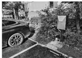
■已经安装使用的充电桩。
