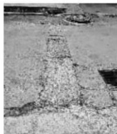
■小区改造之前,挖开路面安装充电桩留下的“疤痕”。
